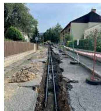
Napojení pošty na obecní kotelnu.
