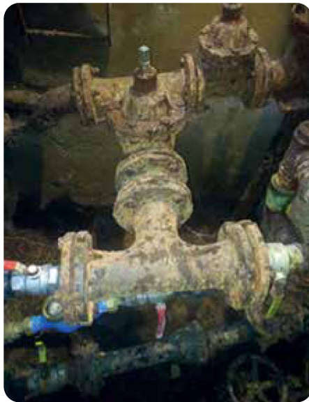
Původní armaturní sestava v rekonstruovaném vodojemu.
